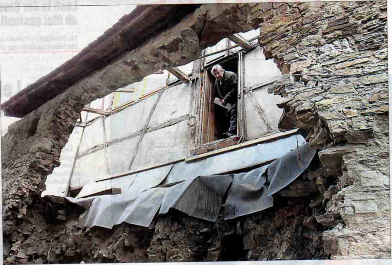
Paul Detzner blickt aus einer Tür an der Rückseite seines Hauses in der Heiligengasse 11 durch das Loch in der Pöbnecker Stadtmauer. Dieses hat sich vor etwa zehn Monaten aufgetan und soll ab Mai saniert werden. (Foto: OTZ/Marius Koity)
