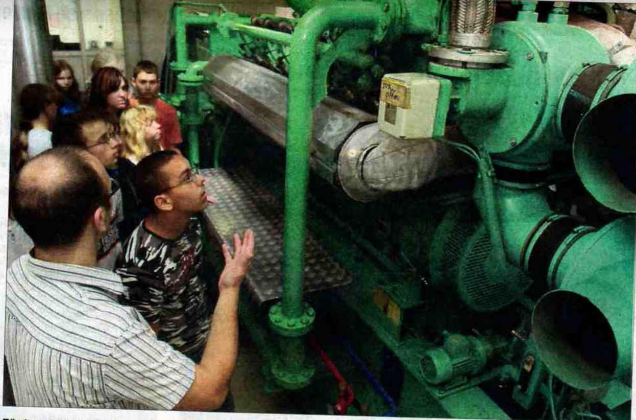
Förderschüler schauen zu Beginn des Schuljahres im Blockheizkraftwerk Pöbneck-Ost der Stadtwerke Energie Jena-Pöbneck mal nach, woher im Winter die Fernwärme in ihren Klassenräume kommt. In der Anlage an der Kurzackerstraße werden gut sechzig Prozent der in Pöbneck verbrauchten Fernwärme erzeugt. (Foto: OTZ-Archiv/Marius Koity)
