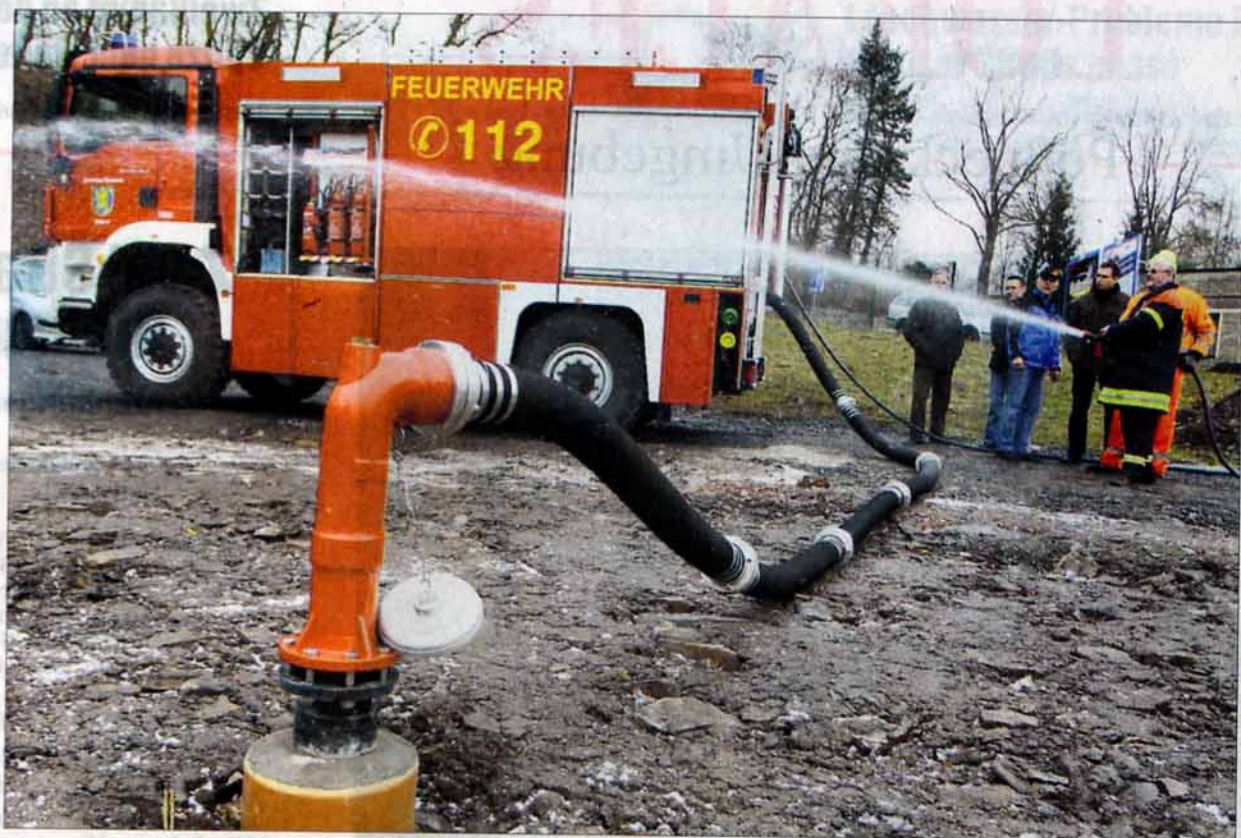
Mit Löschwasser-Problemen ist im Bereich Raniser Straße/Bahnhofstraße in Pößneck nicht mehr zu rechnen, demonstrieren Kameraden der Freiwilligen Feuerwehr gestern an der Zisterne auf dem ehemaligen Streichgarnspinnerei-Gelände. Von dem riesigen unterirdischen Behälter ist oberirdisch nur ein Saugstutzen zu sehen. (Foto: OTZ/Marius Koity)
