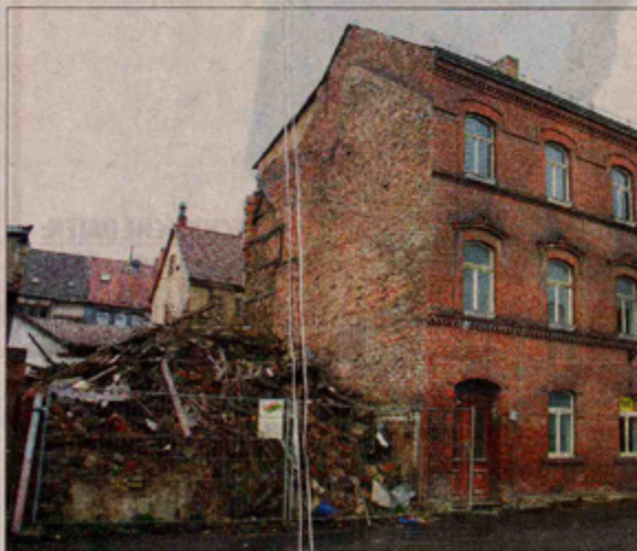
Das leer stehende Gebäude Brauhausgasse 23/25 in Pöbneck. Sicher auch die teils von der Natur begrünzte Bauschuttberge werden im Sommer abgetragen. (Foto: OTZ/mk.o)
