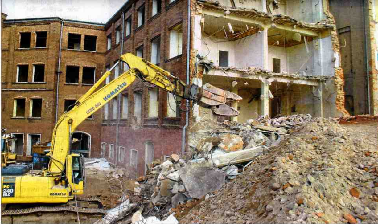
An der Ernst-Thälmann-Straße in Pöbneck wird die nächste Rotasym-Ruine abgetragen. Die Abriss-Schere löst derzeit nach und nach Räume auf, die Tausenden aus der Region als Berufsbildungsstätte gedient haben. Ab 7. Dezember ist das Gebäude unmittelbar an der B 281 dran, so dass diese voll gesperrt werden muss. (Fotos [2]: OTZ/Marius Koity)
