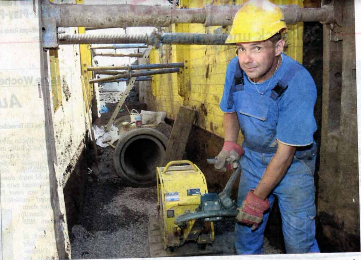
Eine gute Mannhöhe unter der Oberfläche der B 281/Saalfelder Straße in Pöbneck-Öpitz verdichtet Sven Frister von der Firma VSTR aus Rodewisch die Sohle der neuen Kanalisation in dem Pöbnecker Ortsteil. Beim Kanalbau auf der rund einen Kilometer langen Baustelle hat man fast den zweiten von drei Bauabschnitten vollendet. (Foto: OTZ/Marius Koity)
