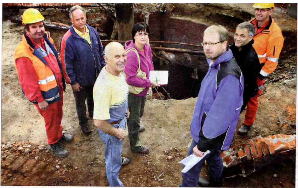
Wie es nach den jüngsten Entdeckungen weiter geht mit der Zisternen-Sanierung auf dem ehemaligen Streichgarnspinnerei-Gelände an der Raniser Straße in Pöbneck berieten gestern v. l. RoHö-Mitarbeiter Reiner Häußer, RoHö-Chef Thomas Roolant, Pieger & Wehner-Geschäftsführer Gerd Querengässer und seine Mitarbeiterin Grit Wehner, Stadtplaner Thomas Wunsch, der Hydrogeologe Dr. Jens Götze und RoHö-Mitarbeiter Erich Babace. (Fotos [2]: OTZ/Marius Koity)
